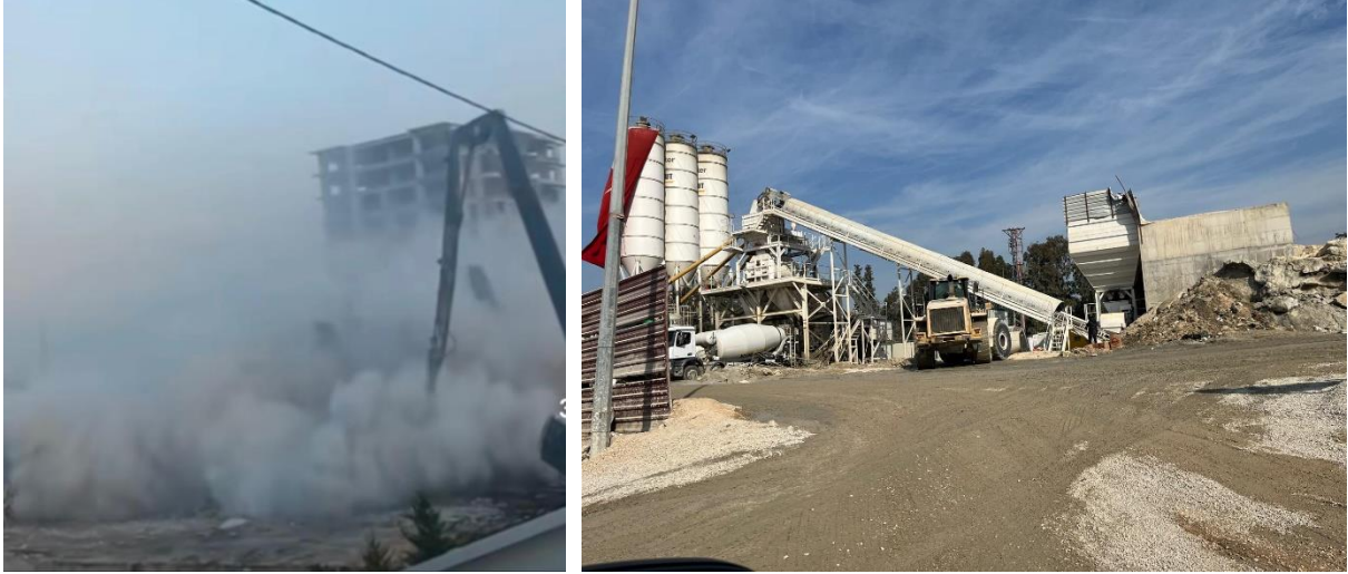
Fotoğraflar: Hatay'daki beton santralleri (Ocak 2025)
